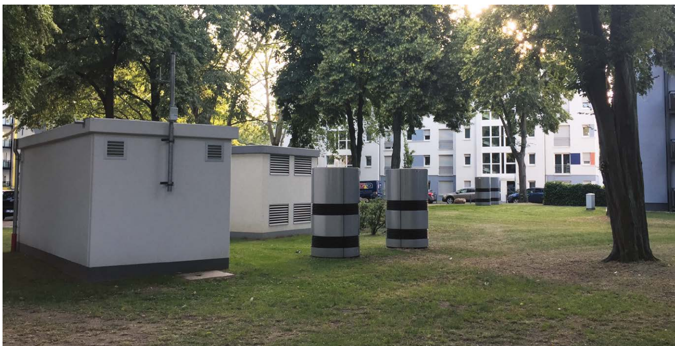
Abbildung 11: Energie-Infrastruktur und Luftwärmepumpen in der Stegerwaldsiedlung. Quelle: Eigenes Foto.
